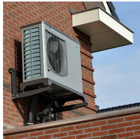
de buitenventilator, hoe groter, hoe stiller . . .
